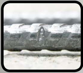
Point de rupture à l'intérieur des murs
