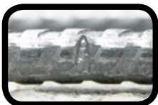
Point de rupture à l'intérieur des murs
